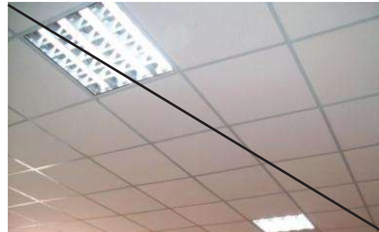
Плохо Открытые направляющие
